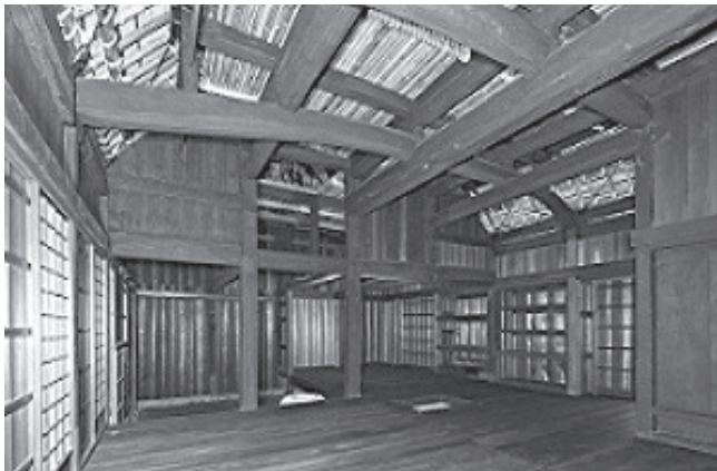
建物の内部は、奥でい(8畳間)は天井板が張ってあるが、そのほかの部屋は天井を張らず梁等の骨組みが見られるようになっております。
